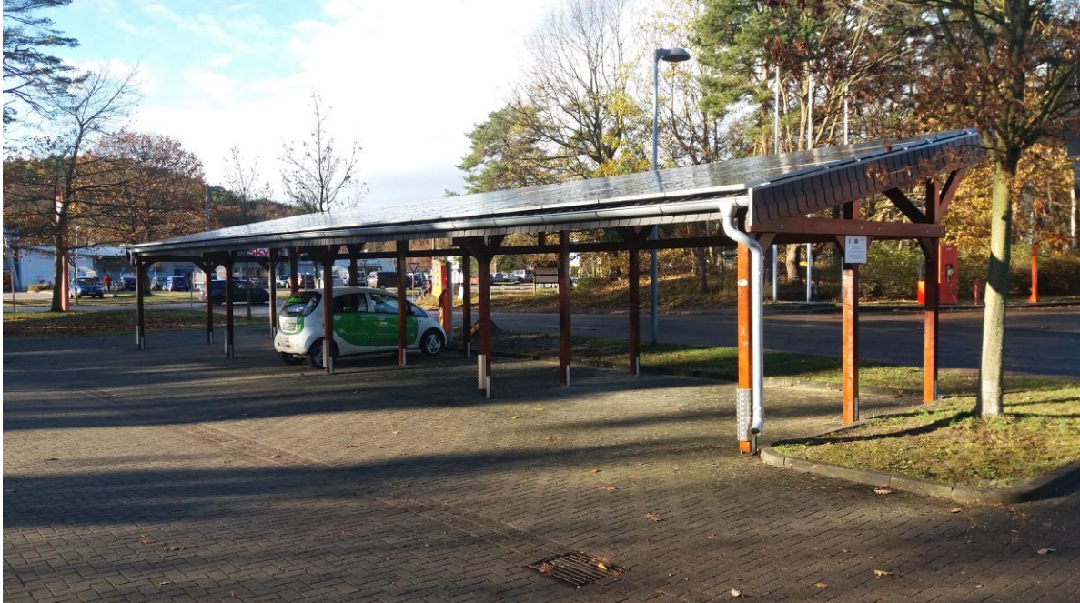
BU: Erneuerbare Energien und Elektromobilität: So könnte eine auf Solar basierende Ladestation für E-Mobile aussehen (Foto: Inselwerke eG).
